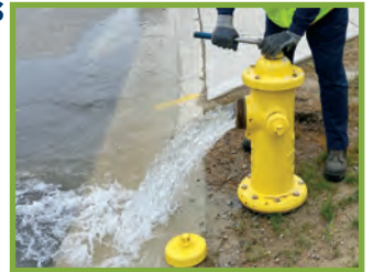
▲ En 2022, City Utilities realizó el mantenimiento de 7,943 de 11,939 hidrantes de Fort Wayne.
